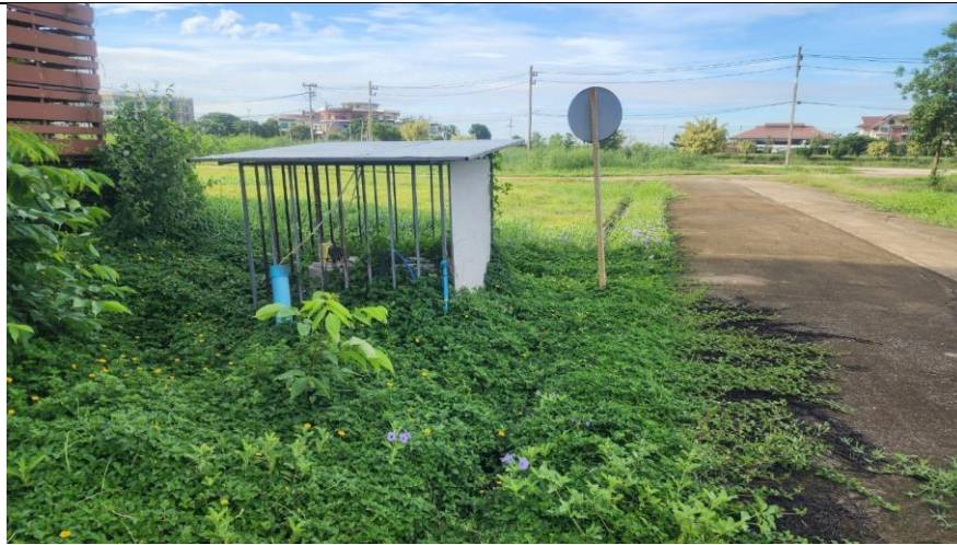
ภาพประกอบ: ถังเก็บน้ำเสียและเติมสารเคมีให้ระบบฝังด้านทิศตะวันตก
