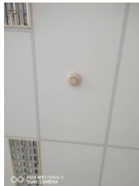
ภาพประกอบ อุปกรณ์ตรวจสอบจับเพลิงไหม้ ในแต่ละห้อง/พื้นที่
