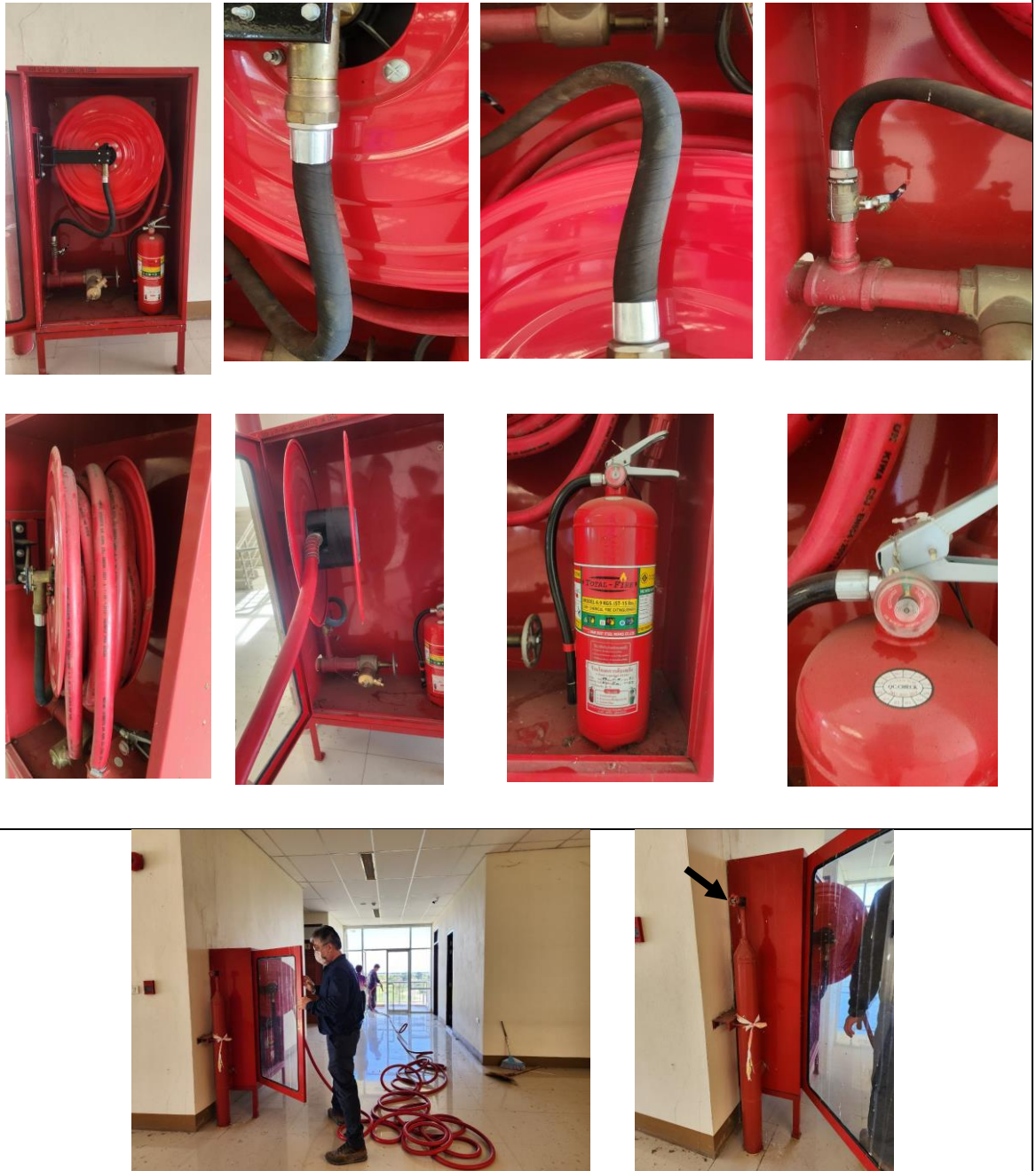
ภาพประกอบ: ตู้ดับเพลิงชั้นที่ 3 ฝั่งตะวันออก
