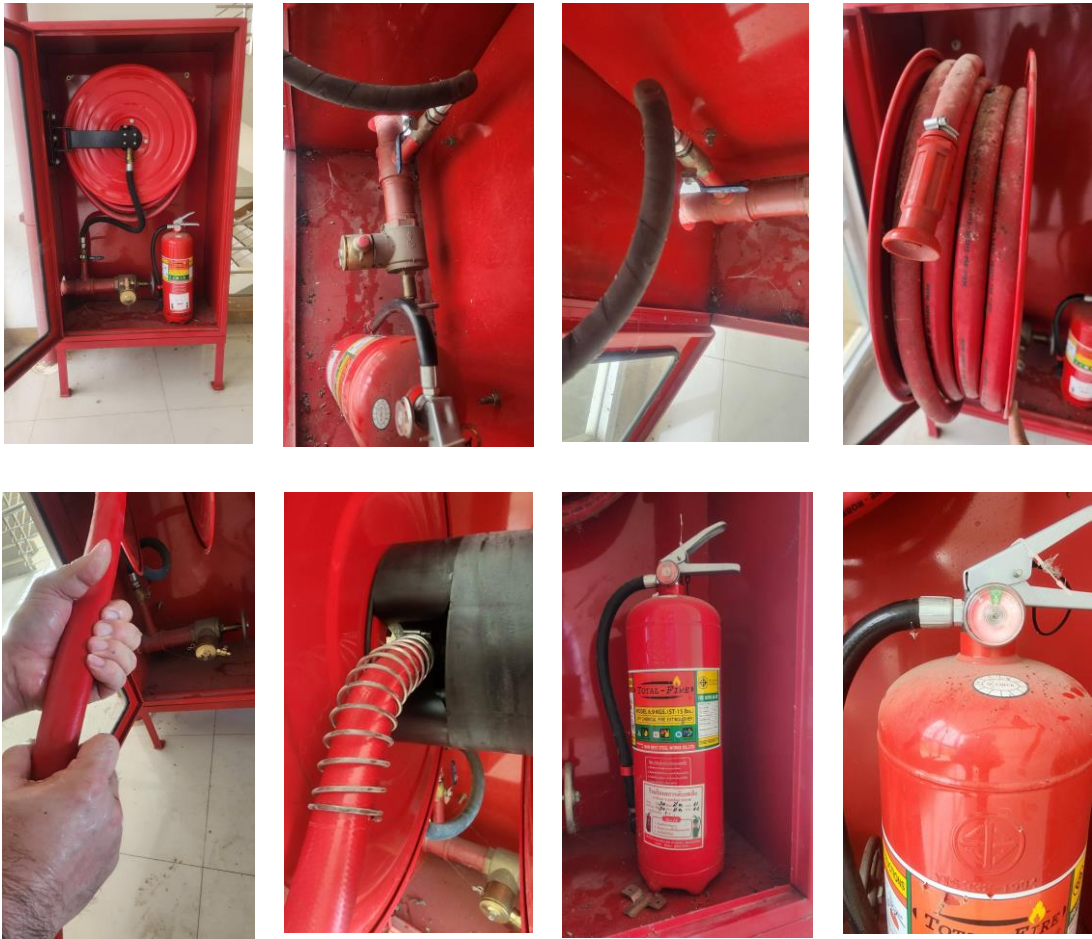
ภาพประกอบ: ตู้ดับเพลิงชั้นที่ 2 ฝั่งตะวันออก
